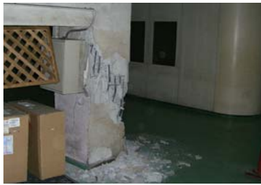
損傷した構内の柱（水戸事業所）
