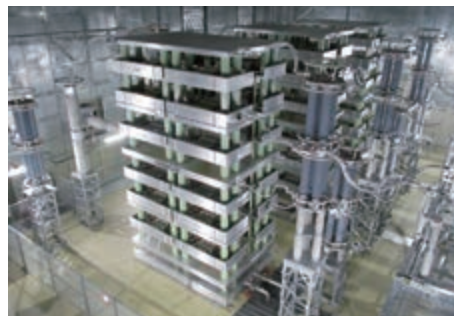
高圧直流送電(HVDC)交直変換装置 (中部電力パワーグリッド株式会社 飛騨変換所)
