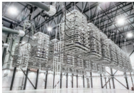
高圧直流送電 (HVDC) の交直変換装置
