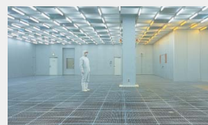
空調システム
