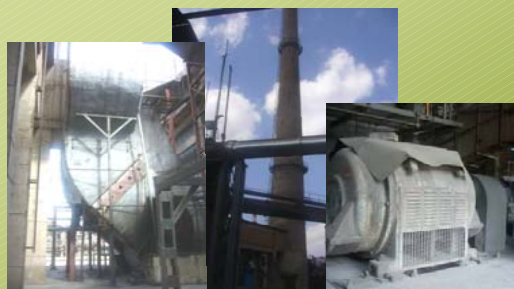
発電用ボイラ 誘引ファン、押込ファン
